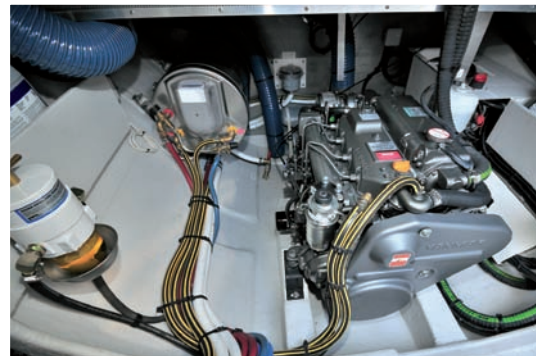
La cale machine est entièrement peinte et dotée d'étagères pour les consommables.
